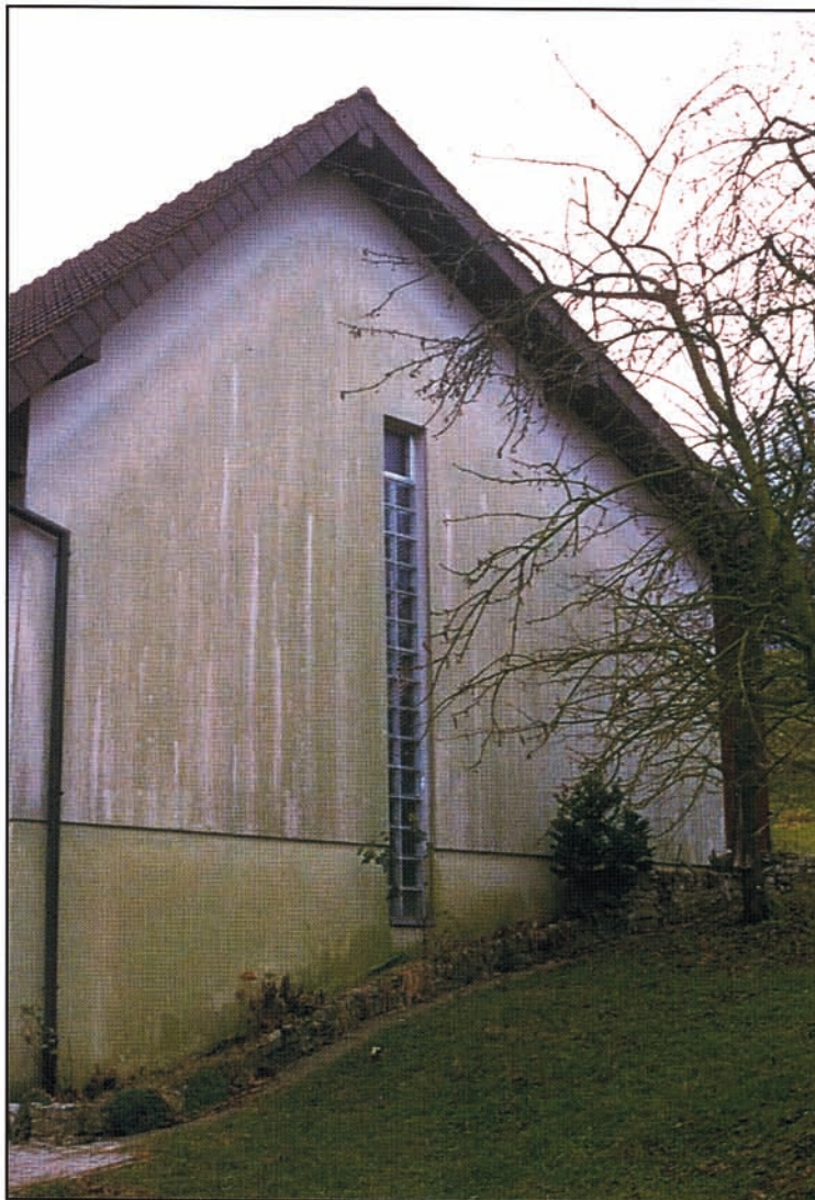
Řasy na fasádě
